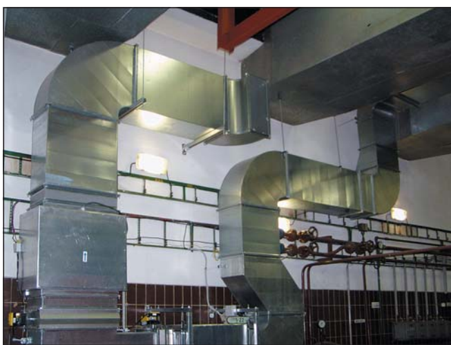
Bilance přívodu spalovacího vzduchu a jeho předehřevu je přebytková následkem snížení celkového instalovaného výkonu; rozvod byl rozdělen na přívod do místnosti ke kotlům (na obrázku) a do místnosti s parním vyvíječem a kondenzačním kotlem
