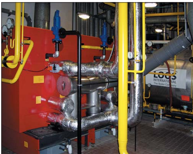
Odvod spalin od kondenzačního kotle (šedý, šikmo vzhůru); vzadu za ním je ponechaný vyvíječ páry Loos
