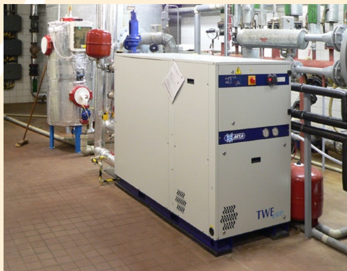
Tepelné čerpadlo TWE využívá odpadní teplo z jevištní hydrauliky
