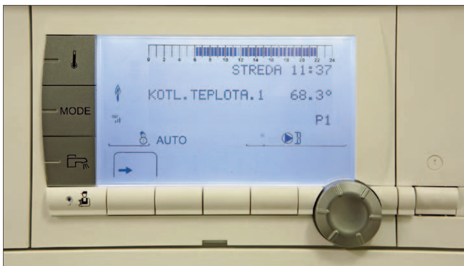
Technologická úsporná opatření ve školách na území městské části Praha 13 zahrnovala nové kotelny s kondenzačními kotly, systémy individuální regulace vytápění, úsporné osvětlení, spořiče pitné vody apod.
